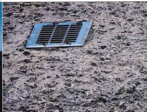
Fot. 12 Zabezpieczone i czyste otwory wentylacyjne
