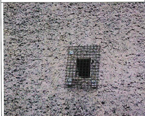
Fot. 3 Czyste wyloty otworów zabezpieczone kratkami
