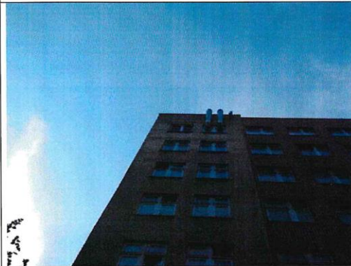
Fot. 11 Elewacja budynku – brak szczelin, gniazd
