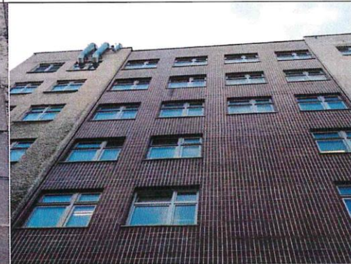
Fot. 14 Elewacja z klinkieru bez jakichkolwiek śladów zanieczyszczenia guanem
