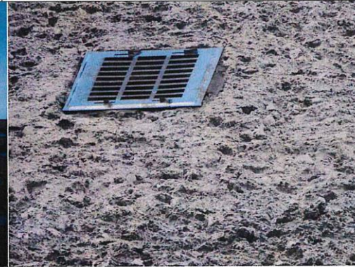
Fot. 12 Zabezpieczone i czyste otwory wentylacyjne
